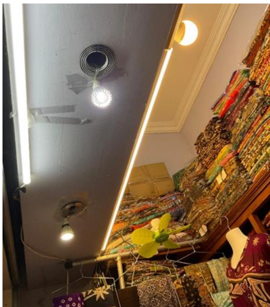
Gambar 5. Penempatan Lampu Kios B (Sumber: Dokumentasi Penulis)
