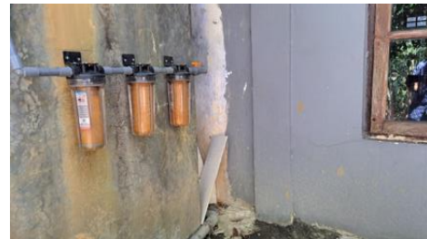
Gambar 7. Seperangkat alat BSF yang dipasang di sebelah tempat penampungan air masjid
