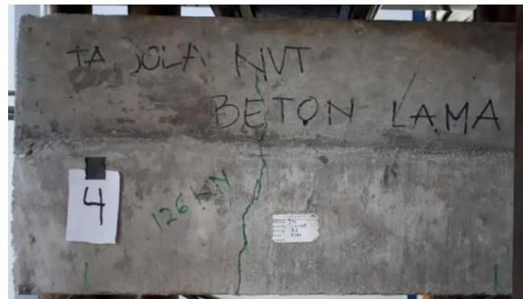
Gambar 15. Pola Retak Pada Balok Beton Komposit
