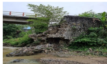
Gambar 2. Kondisi Keadaan Abutmen Pada Tanggal 15 Agustus 2022
