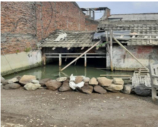
Gambar 1 Dampak Rob Terhadap Infrastruktur
